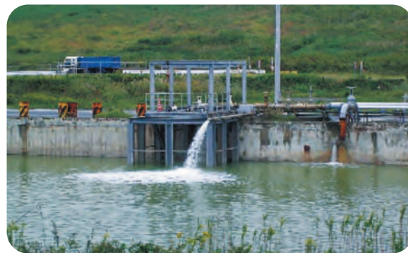
ポンプ井（集水池）
