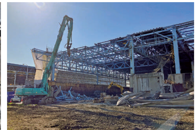
不燃ごみ受入ヤードの解体工事 （中防不燃ごみ処理センター 第一プラント）
