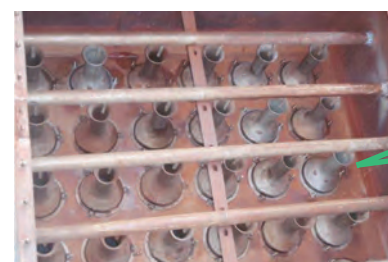
ろ過式集じん器の内部（有明清掃工場）
