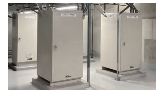
排ガスの自動測定機（板橋清掃工場）
