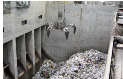
ごみバンカとごみクレーン (大田清掃工場)
