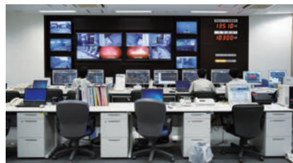
中央制御室(練馬清掃工場)
