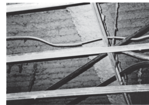
柱や壁、天井裏にアスベストが吹き付けられていました。
