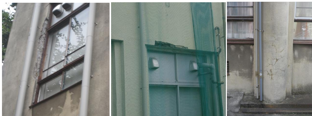
写真-24：旧元町小学校 外壁・モルタルの剥離や浮き、ひび
