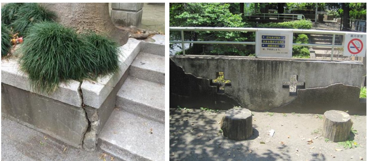
写真-21：元町公園 劣化が顕著な部分
