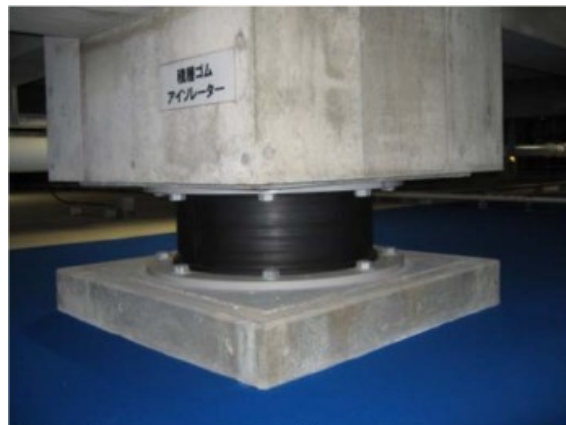
▲本部棟の免震装置(配付資料より引用)
