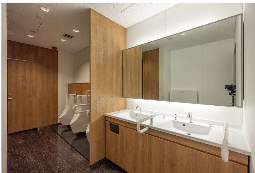
男子トイレ（ベビーチェア、フィッティングフロア、ベビーベッド各 1 か所設置）
