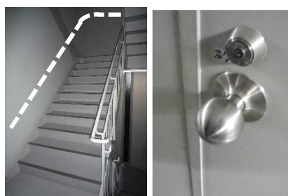
B) 避難階段手摺未設置部・ドアノブ
