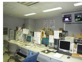
中央監視装室
