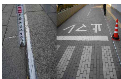
C) 構内道路と歩道の段差
