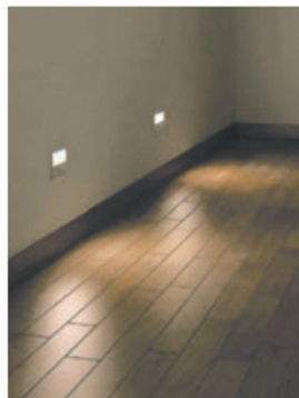
■足元灯の設置
